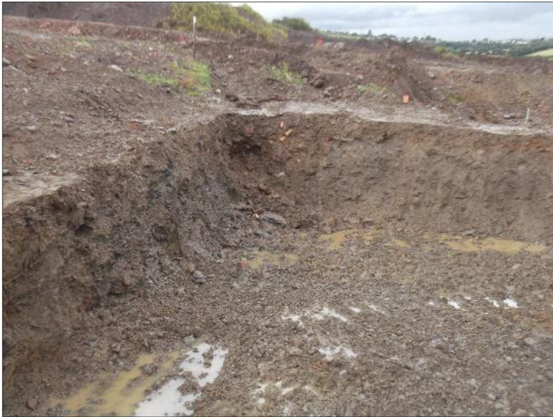
34) IP4082 RBSL failure excavation.
